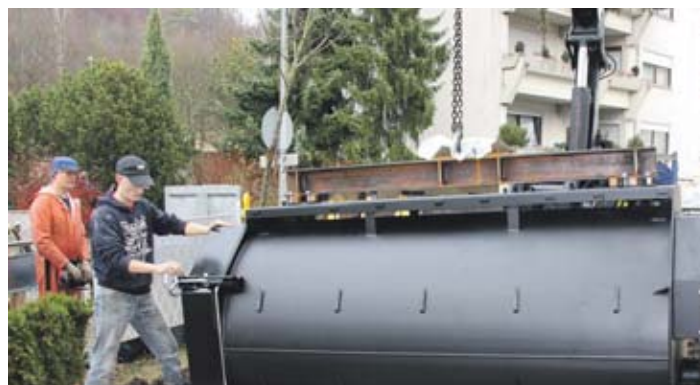
Der Biomassekessel für die Pellets wird in einem Gebäude installiert und versorgt von dort aus auch alle anderen Objekte sternförmig mit Wärme.
