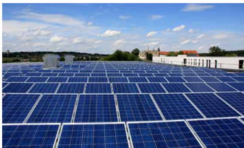
Rund 810 Photovoltaik-Module glänzen auf dem Dach des Congress Centrums
